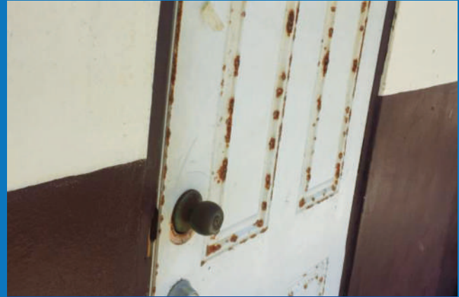
■ CORRODING METAL DOOR
